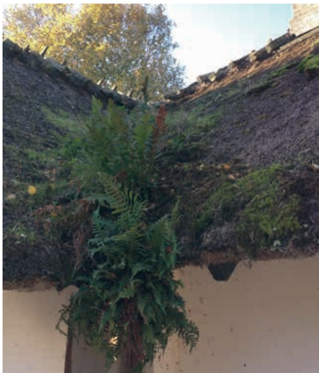
Foto 63 Manglende vedligehold af taget
